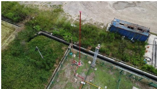
放散管及排水沟渠
