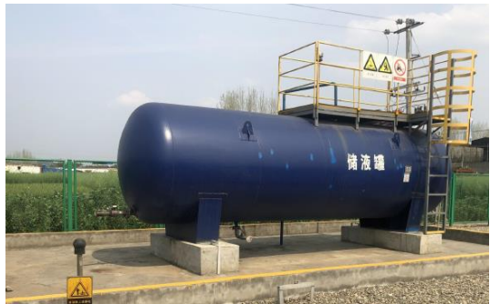
污水罐及围堰
