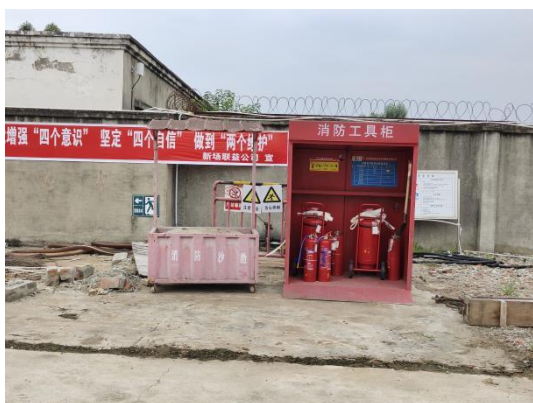
联 111 井站消防设施
